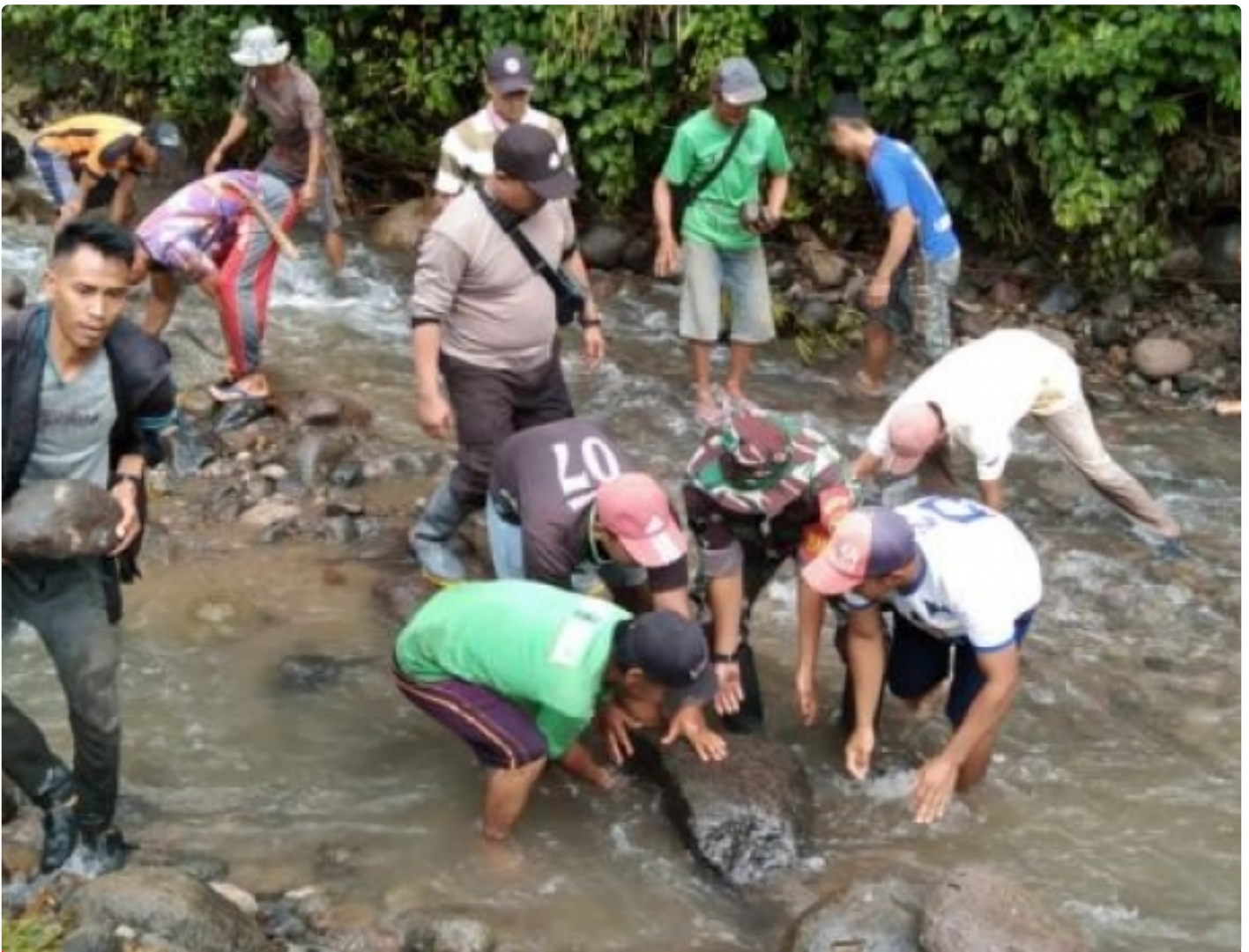
Babinsa Sertu Fahrul Efendi Bersama Masyarakat Melaksanakan Pembuatan Jembatan Kayu Sebagai Penghubung Pekon.
